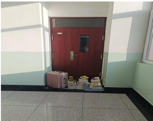
楼道堆积杂物
